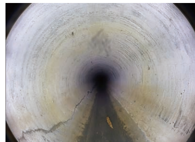
排水管ひび割れ
